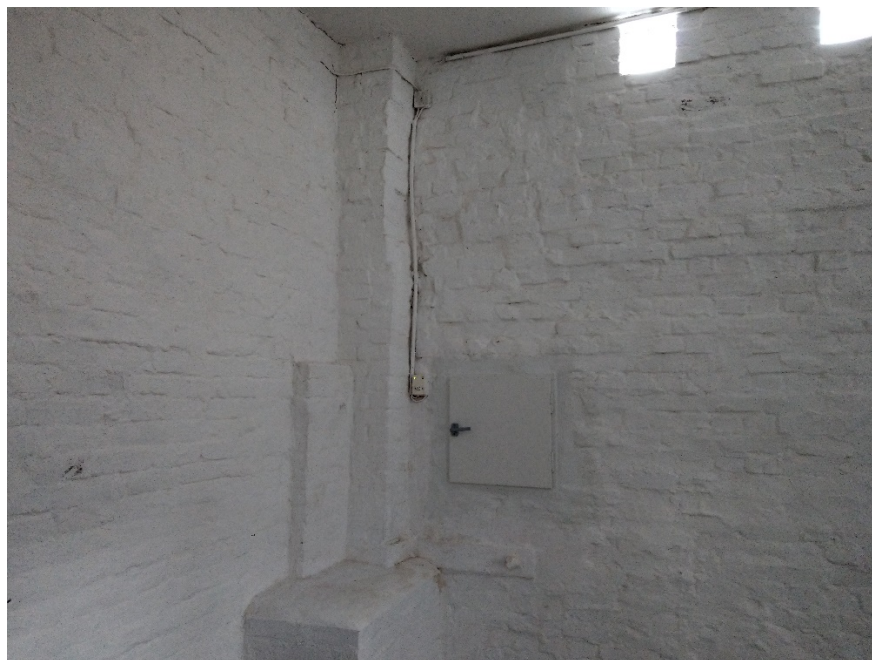
Transformatorrom ferdig oppusset
