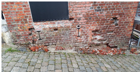
Fasadeskader på nordvegg
