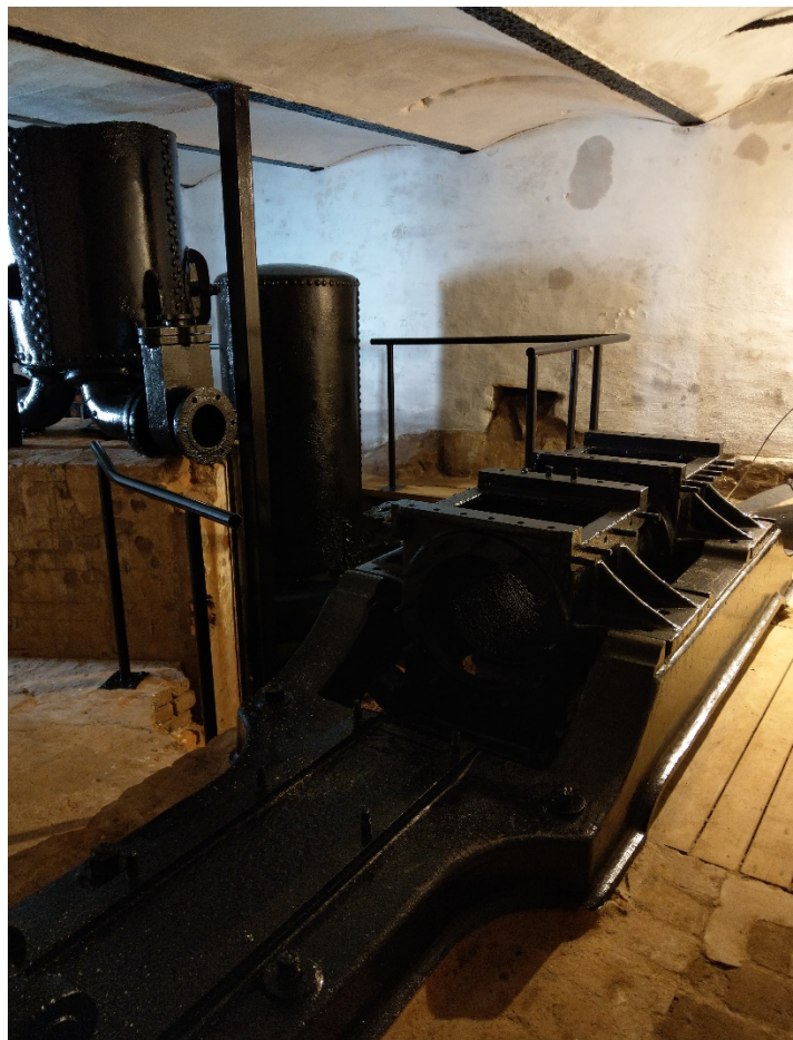
Pumperom med trykktanker ferdig rehabilitert
